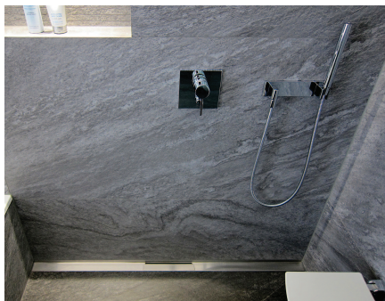
Die Dusche wird mit einer Duschrinne über die ganze Breite der Rückwand entwässert.
